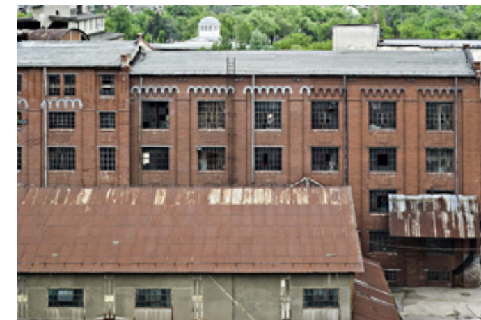
Fragment din clădirea dispărută astăzi, după distrugerea tâmplăriilor, prăbușirea interiorului, a acoperișului și inevitabilul colaps al fațadei (foto aprilie 2008).
