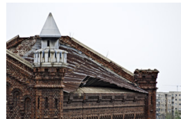
Ultima bucată rămasă din acoperișul clădirii principale (foto aprilie 2012).
