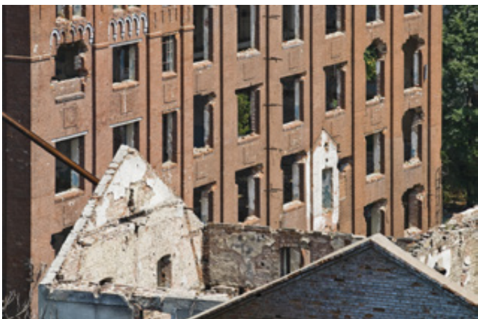
Inconștiența (și dispererea) hoților de metale este ilustrată perfect în acest cadru: se fură până și buiandrugii din metal. Puteți observa în stânga imaginii ultimii buiandrugii, recuperați câteva săptămâni mai târziu. Interiorul clădirii încă este în picioare, se va prabuși la sfârșit de 2011 (foto august 2010).
