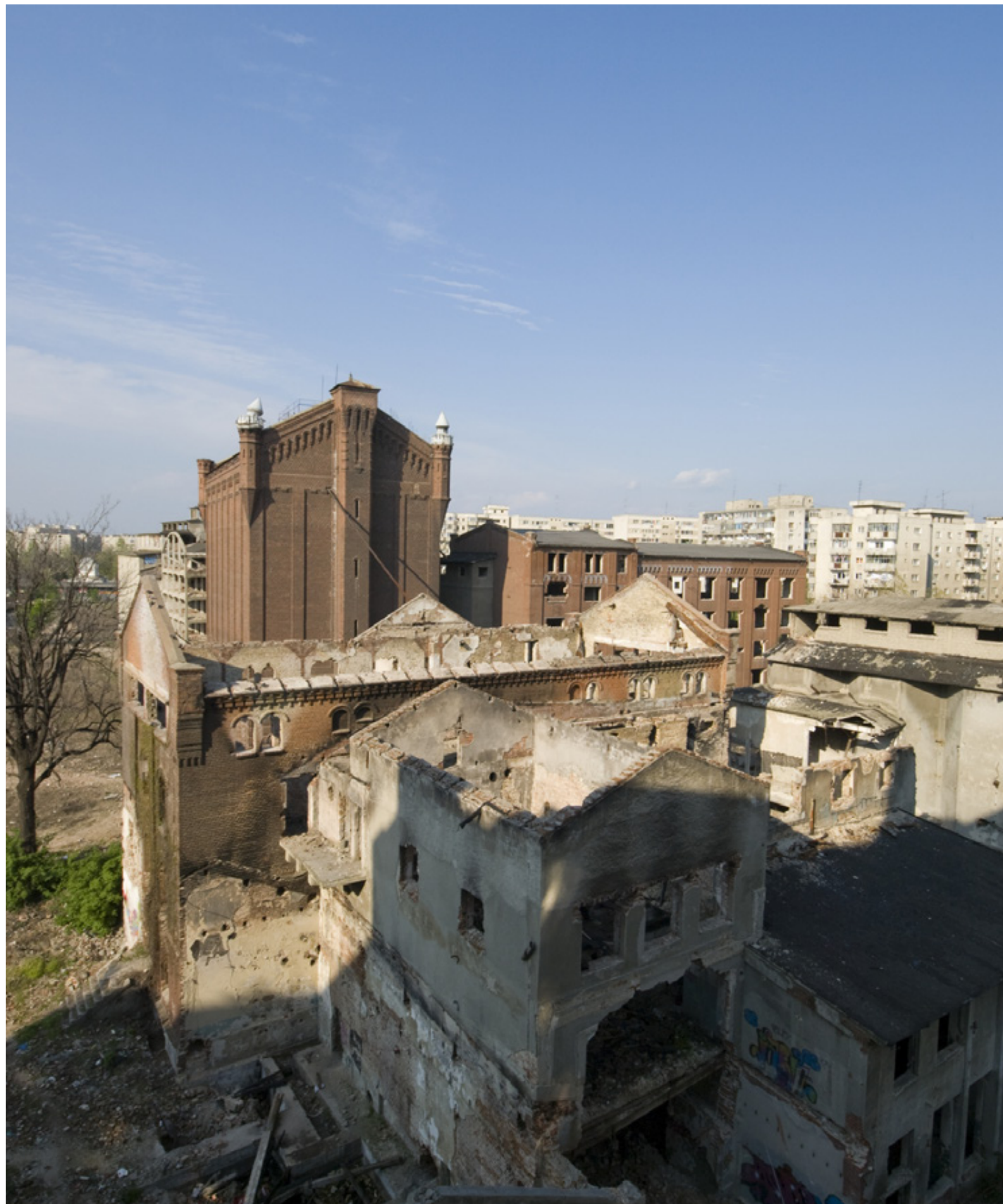
Clădirile din prim plan au fost puternic afectate de incendiu și furturi, clădirea principală rezistă încă efortului de „reciclare” (foto aprilie 2010).
