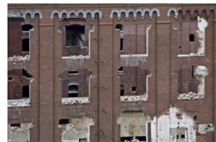
Fațada clădirii prăbușite de curând, redusă la o „coajă” din cărămidă (foto aprilie 2012).
