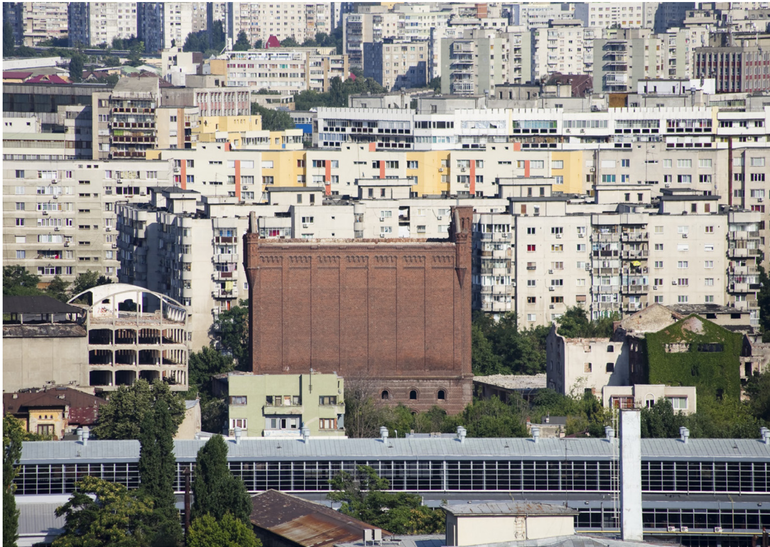
Clădirea principală, după dispariția totală a acoperișului (foto iunie 2012).
